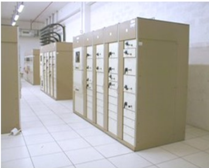
Poste de distribution BT
