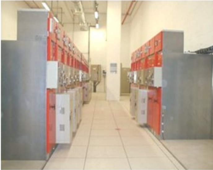
Poste de livraison et protection HTA
